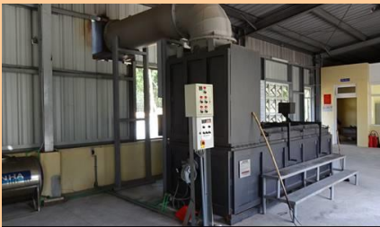
Lò đốt chất thải y tế nguy hại của HEPCO tại Thủy Phương
